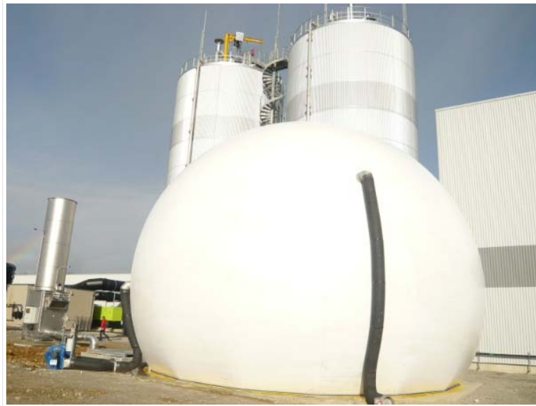
Cette grosse boule est un gazomètre. Stock tampon, ce réservoir conserve entre 20 minutes et une demi-heure de production de gaz avant l'injection dans le réseau. Il est couplé à une torchère (à gauche). ©Traces Ecrites.
