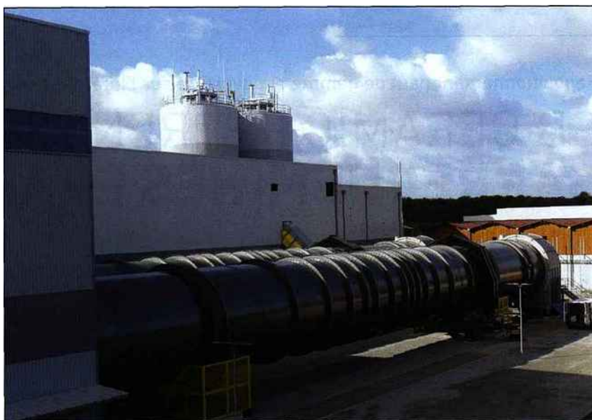
Les tubes malaxeurs de l'usine Ecocea.
