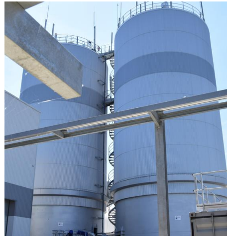
Les deux « estomacs » de 26 mètres de hauteur ont été baptisés Stuart et Kevin (pour expliquer aux nombreux scolaires qui visitent le site le fonctionnement semblable à celui de l'estomac d'une vache. « 100 tonnes de déchets ingérés restituent 80 tonnes de matières, le reste c'est du gaz ».
