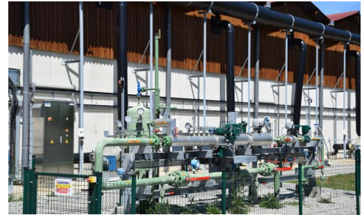
Poste de détente pour envoyer le gaz aux digesteurs.
