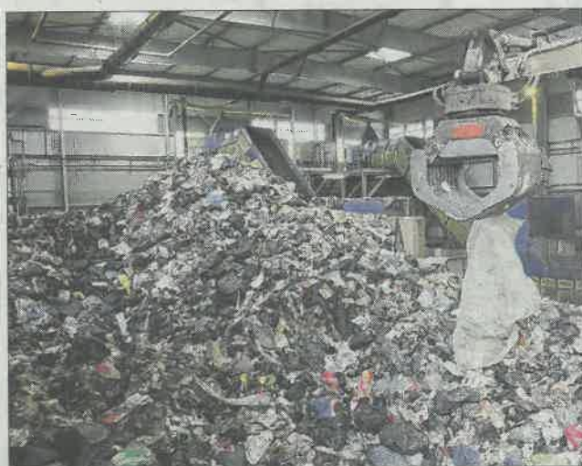
■ Ecocéa, l'unité de tri, méthanisation et compostage des déchets ménagers à Chagny fonctionne à plein régime. Photo Grégory JACOB
