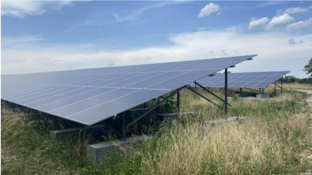
Les 8 370 panneaux produisent de l'électricité de leurs deux faces. Photo JSL /Martin DUBREUIL
