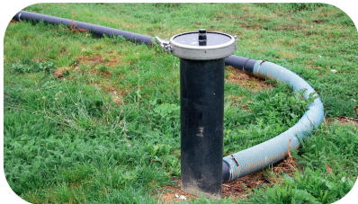
Récupération du biogaz
